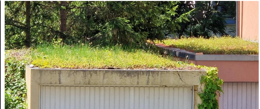
Bild: Extensive Dachbegrünung auf Garagen (Quelle: Stadt Jena)
